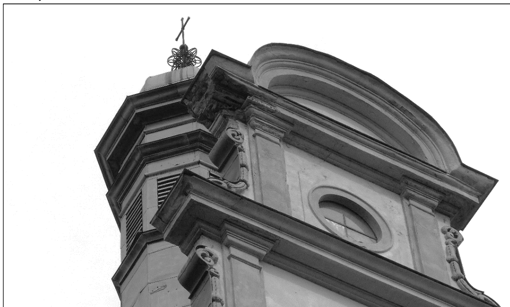
Fot. 6. Uszkodzenia wieży kościoła
