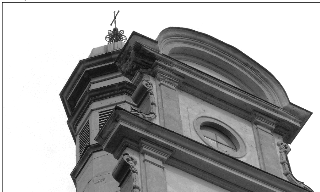
Fot. 6. Uszkodzenia wieży kościoła
